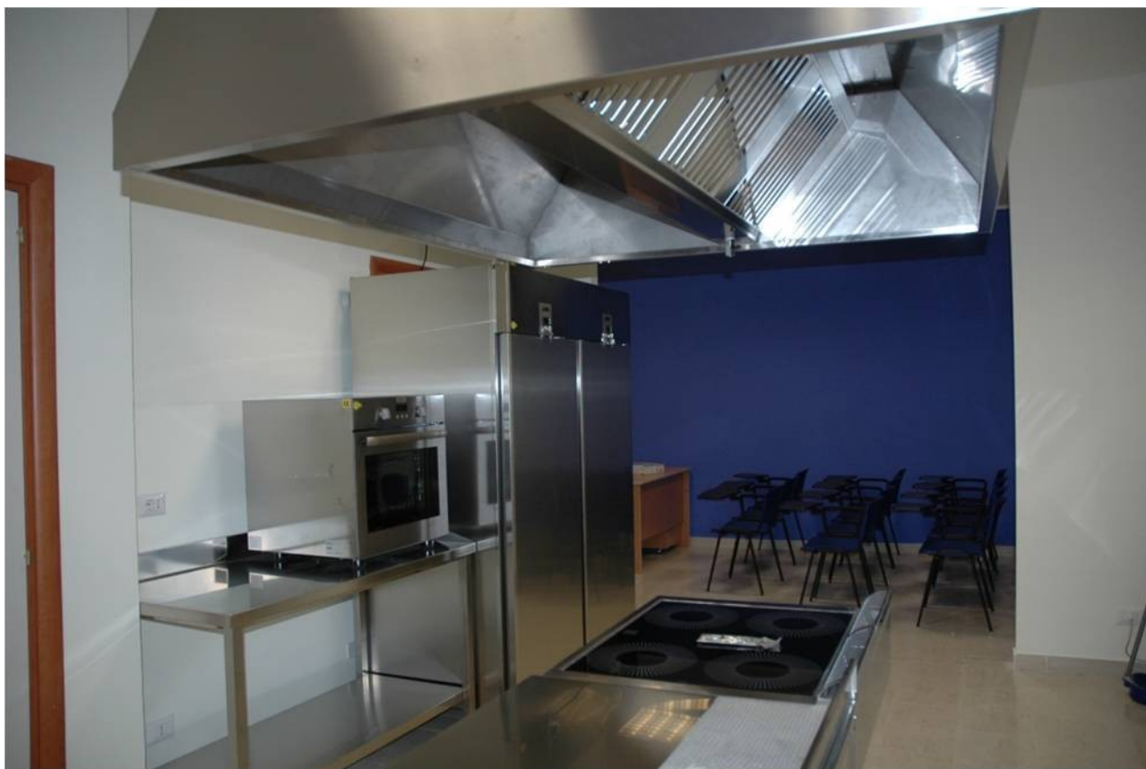
Figura 2: Cucina Didattica realizzata dal SIAN ASP Catania
